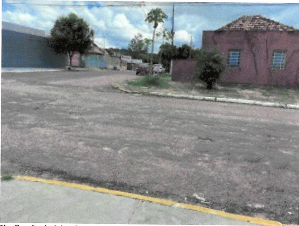
Sinalização de faixa de pedestre neste cruzamento.
